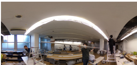
図12 配線ダクト(360度カメラで撮影)
