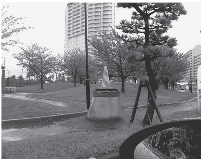
図表6 マンホールの隆起（新町）著者撮影（2011.4.24）
