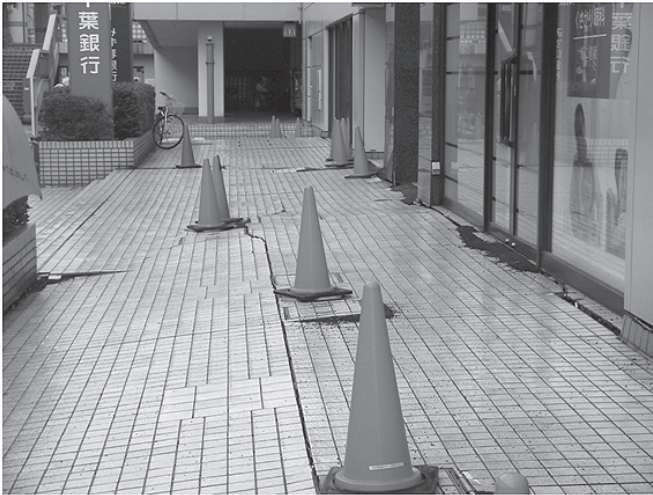
図表4 浦安駅ビルの状況（通路が液状化で波打ち、建物の地面との間に亀裂が入っている）著者撮影（2011.4.24）
