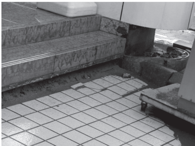
図表5 液状化で地面が陥没し、建物の基盤が剥き出しになっている（中町）著者撮影（2011.4.24）
