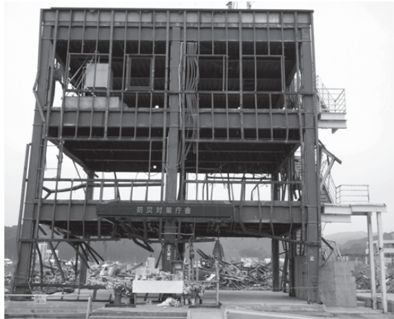
図表7 津波により全壊した南三陸町の防災対策庁舎 著者撮影(2011.8.26)
