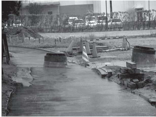
図表1 液状化により道の真ん中で隆起したマンホール（千葉県幕張） 著者撮影（2011.4.24）
