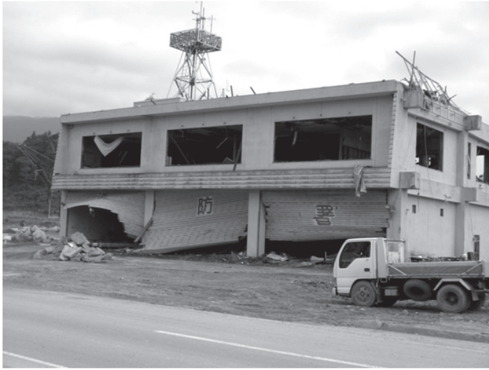
図表8 津波により全壊した陸前高田市の消防署 著者撮影 (2011.8.26)
