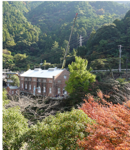
（図6）旧端出場水力発電所（中央・煉瓦造の建物）をマイントピア別子から望む。耐震補強等工事による屋根の葺き替え中であり、架けられている波形鉄板は、既存（改修当時）の色合いに合わせられている。2021年11月撮影。
