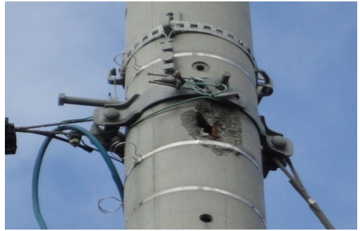
図3 電柱の被害例
