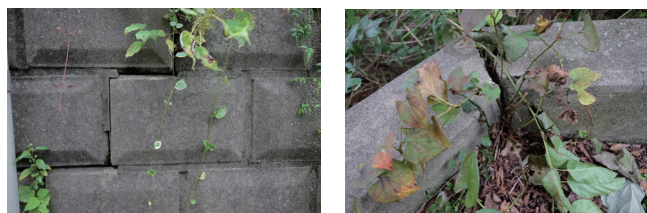
図2 敷地周辺の状況と亀裂
