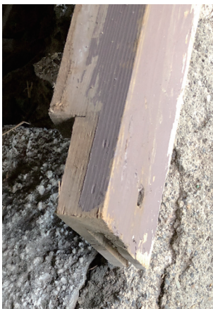
図 2：床下木部表面のペンキ塗り仕上げ
