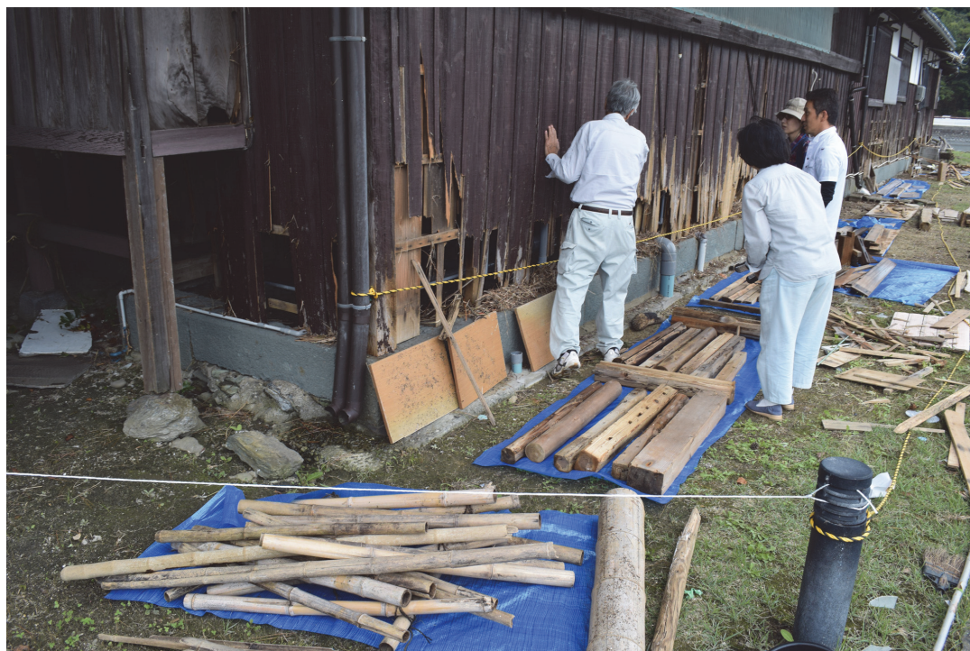
図 7：外壁足元が高潮により破損した。和歌山市役所担当者と大工により状況調査が行われた。足元に並べられた部材は日根茂氏が台風後に島を掃除して部材を拾い出したものである。
