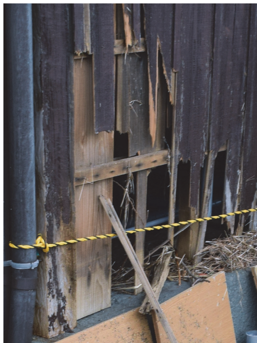
図 8：腰壁下に見つかった杉板縦羽目張りの古板
