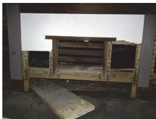
図 9：モルタル製亀腹上の破損した漆喰風小壁 ガラリが設けられている
