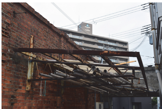
図 4：破損したカーポートの樹脂製屋根
