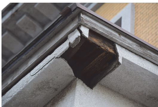
図 5：破損した西面トイレ増設部屋根庇
