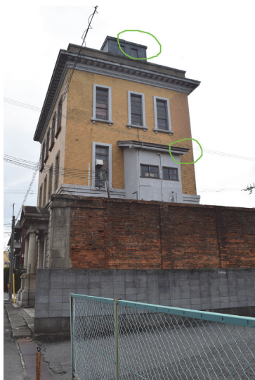
図 1：ビル西面、印は破損部分
