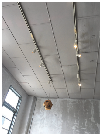
図6：照明が点灯している天井のあたりから雨漏りがあった
